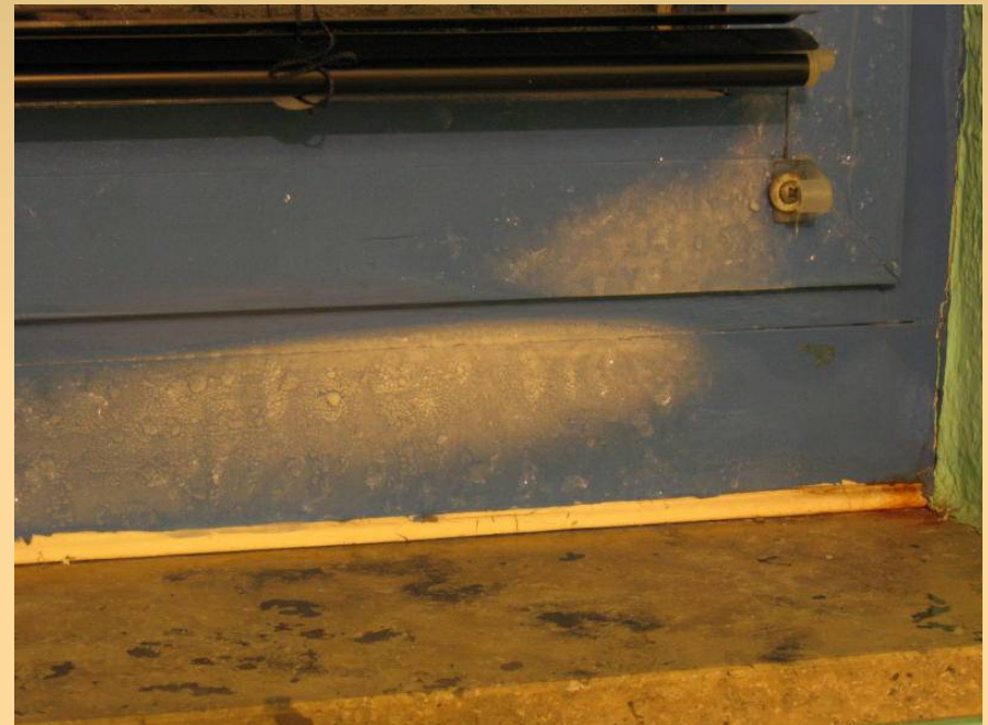
vereister Fensterrahmen bei -13 °C
